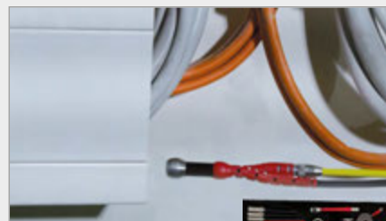
Schächte und Unterflurkanäle RUNPOSTICKS
