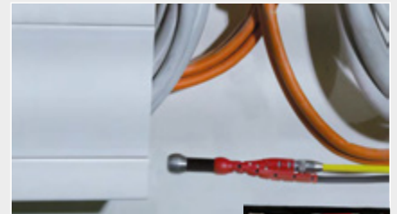
Schächte und Unterflurkanäle
